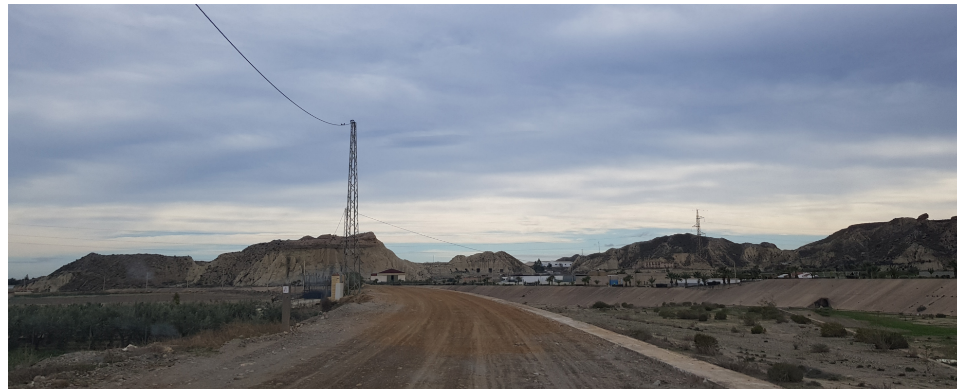
Algunas de las obras ya están en marcha, en la zona del río hacia Villaricos.
